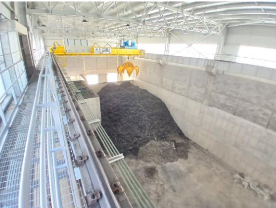
Instalación de almacenamiento y transformación de combustibles alternativos en la planta de Tepetzingo (México)
